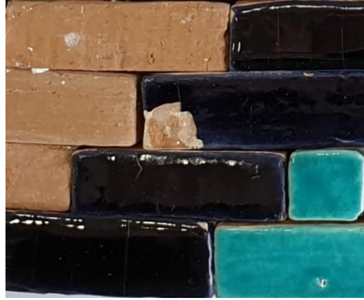
Resim 2: Sırlı tuğlada meydana gelen taş atkını (kireç atkını).
