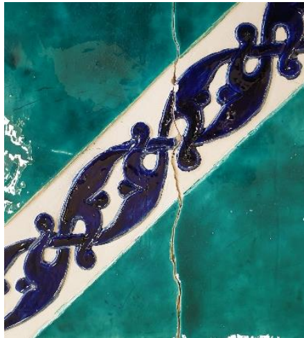
Resim 6: Plaka açılırken tam kaynaştırılmayan birleşim sınırında zayıflamaya bağlı gelişen çatlak
